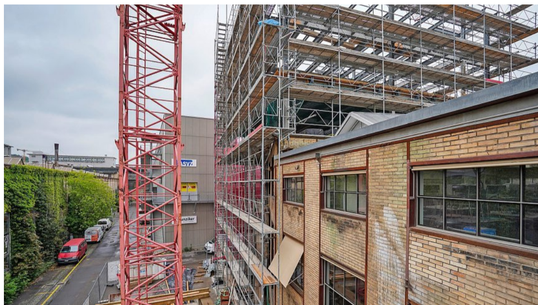
Von aussen sieht der Aufbau heute noch aus wie eine normale Baustelle...
