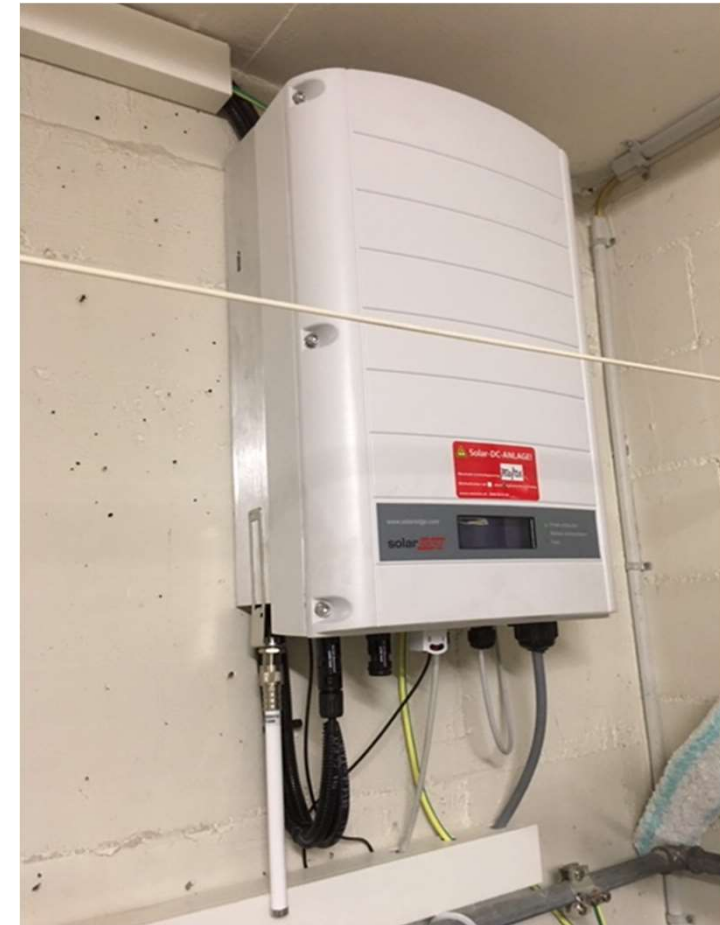
SOLAREEDGE Wechselrichter in der Waschküche
