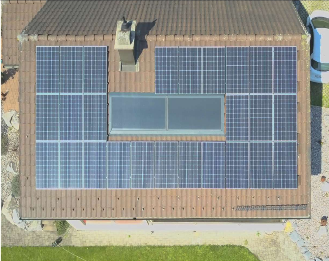
Solarpanel auf dem Dach mit einer Drohne fotografiert
